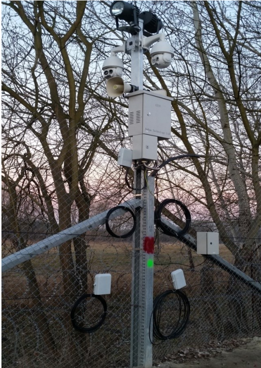
4. ábra: Telepített hőkamera, hangos bemozdó, optikai kábel és nagy teljesítményű reflektor (Készítette a szerző)
